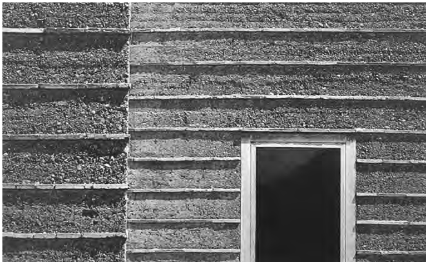
Die dem Wetter exponierte Fassade des Haus Rauch kurz nach der Fertigstellung 2008 (oben) und nach zwei Jahren Erosion (unten).
