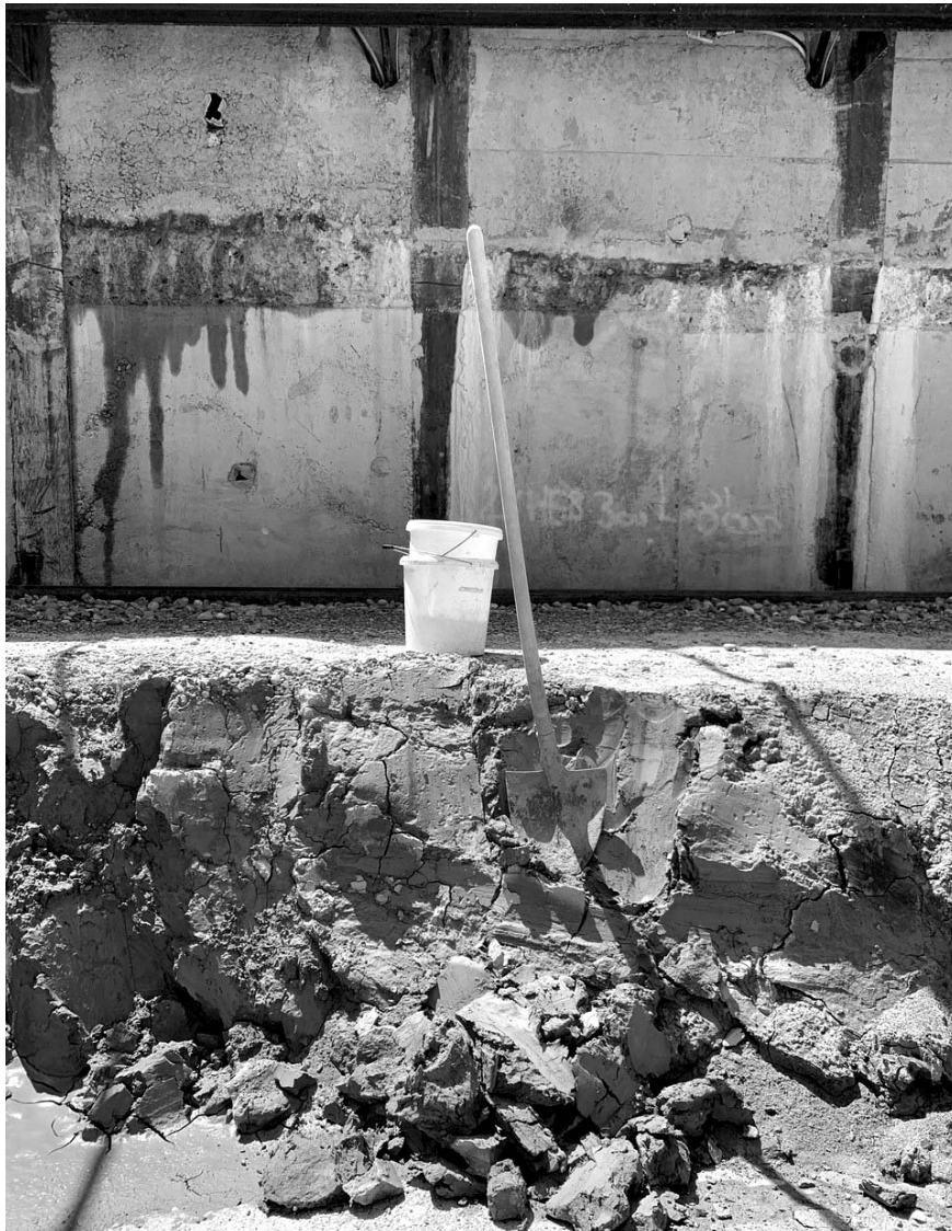
Fetter Lehm Boden in einer Baustellengrube in der Binz (Fotografie: Felix Hilgert)
