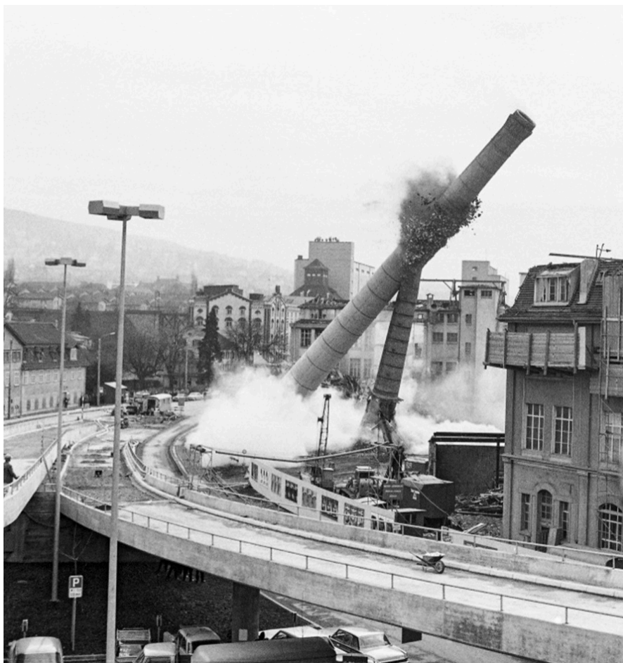
Sprengung Hochkamine Escher-Wyss Quelle: ETH-Bibliothek Zürich, Bildarchiv Fotograf: Comet Photo AG (Zürich)
