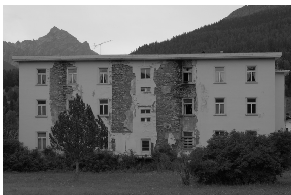
Bruchsteinmauerwerk unter abgeplatzttem Putz
